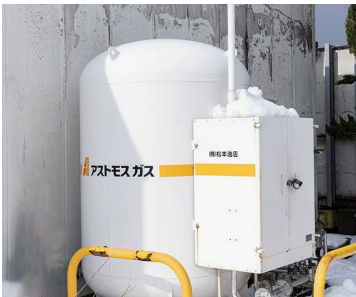
皆生グランドホテルに設置されているCN-LPGタンク(約2t分)。
